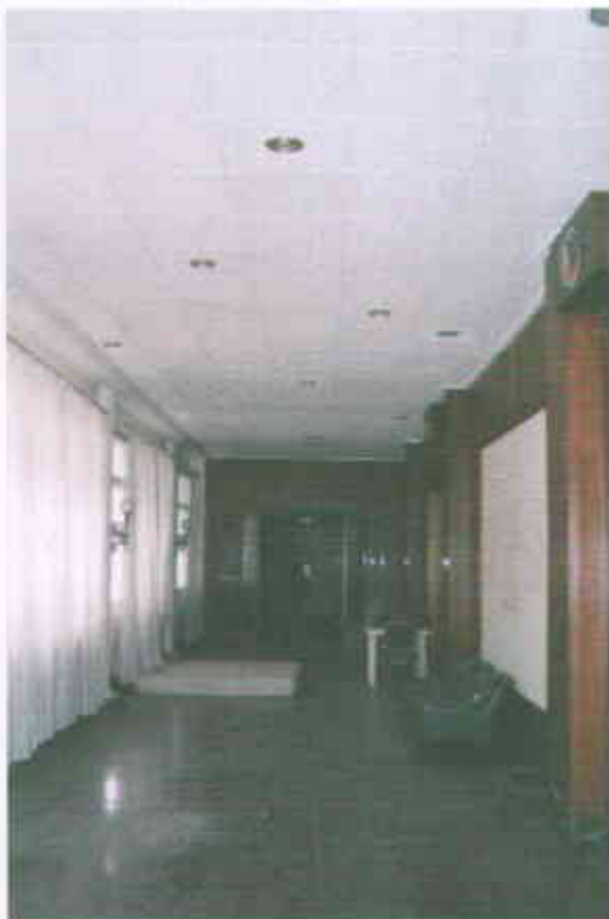
Fotografia núm. 21. Aspecte actual del hall, el qual no conserva cap vitrall ni element decoratiu de l'antic hotel. A més es irrecuperable la seva funció d'accés a l'hotel des de la galeria que, també enderrocada, el connectava amb el parc. Any 1998.
